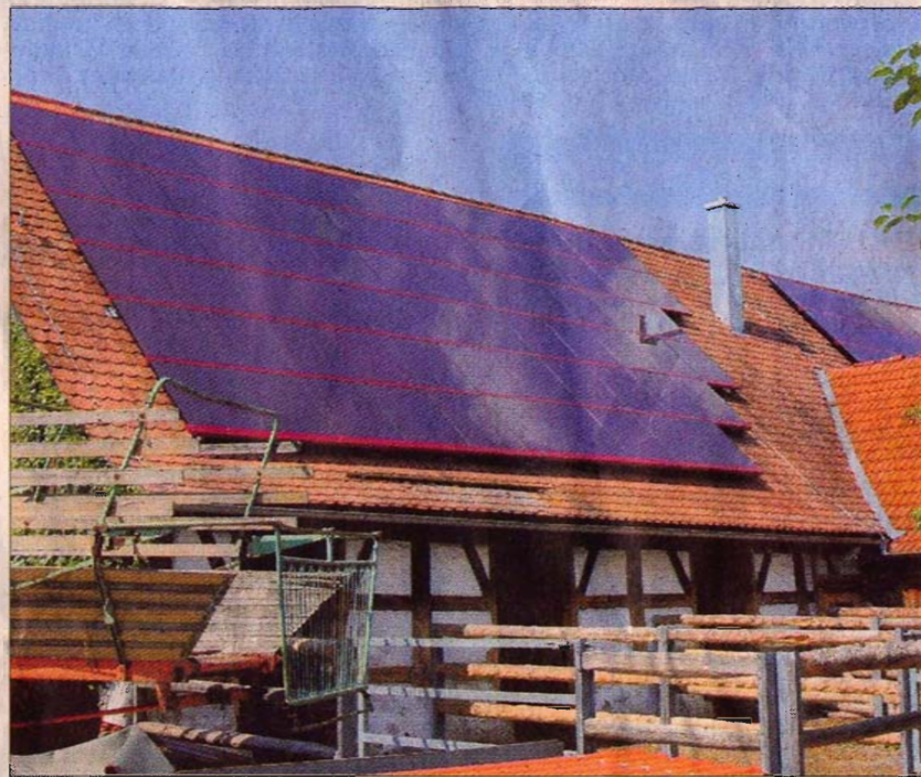
Sogar auf der denkmalgeschützten Schafscheune wurde eine Photovoltaikanlage installiert. Die Rahmenfarbe musste allerdings angepasst werden. Foto: privat
