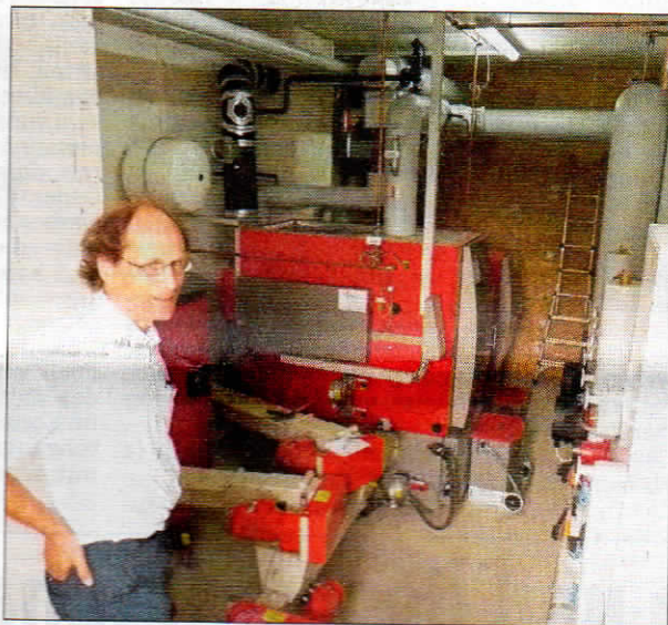
Zwei Brenner verarbeiten vollautomatisch die Hackschnitzel und sorgen für Wärme für die 110-köpfige Dorfgemeinschaft. Foto: Lauer
